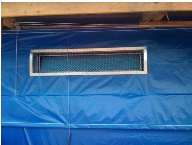
Inlet de parede
